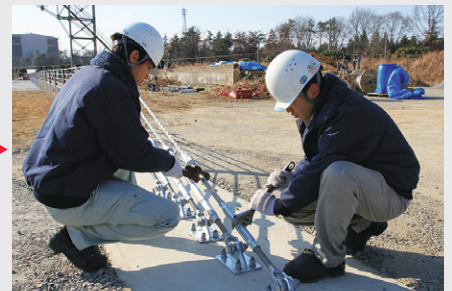
9 ターンバックルにより張力の調整を行い、連結材を取り付けます。
