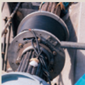
太径ケーブルの測定例
