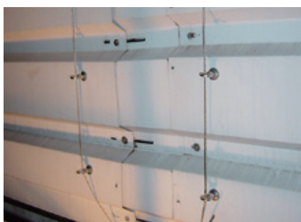
遮音板落下防止ワイヤロープ
