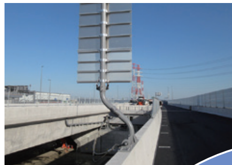
標識柱落下防止ワイヤロープ
