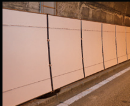
内装パネル落下防止ワイヤロープ
