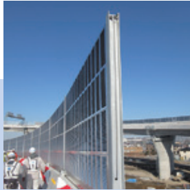
遮音板落下防止ワイヤロープ
