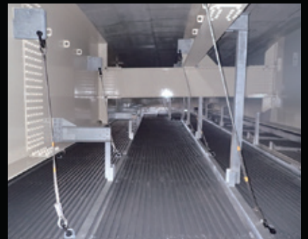
天井板落下防止ワイヤロープ
