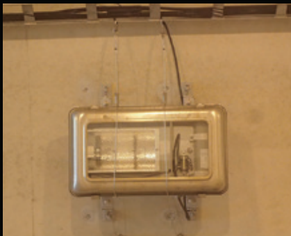
照明灯具落下防止ワイヤロープ
