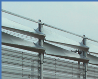
変風向吹上板(風上側)
