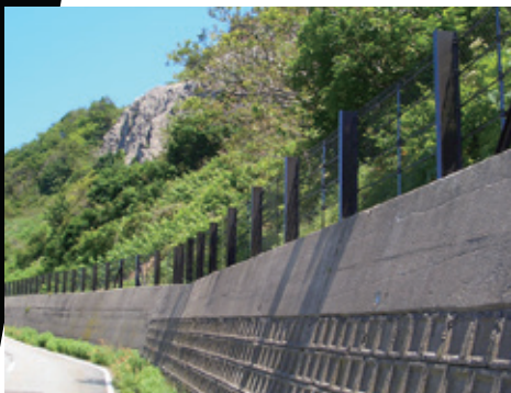
ロックフェンス
