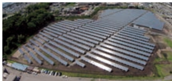
八戸太陽光発電所
